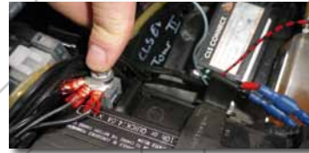
Graues Kabel auf Masse
